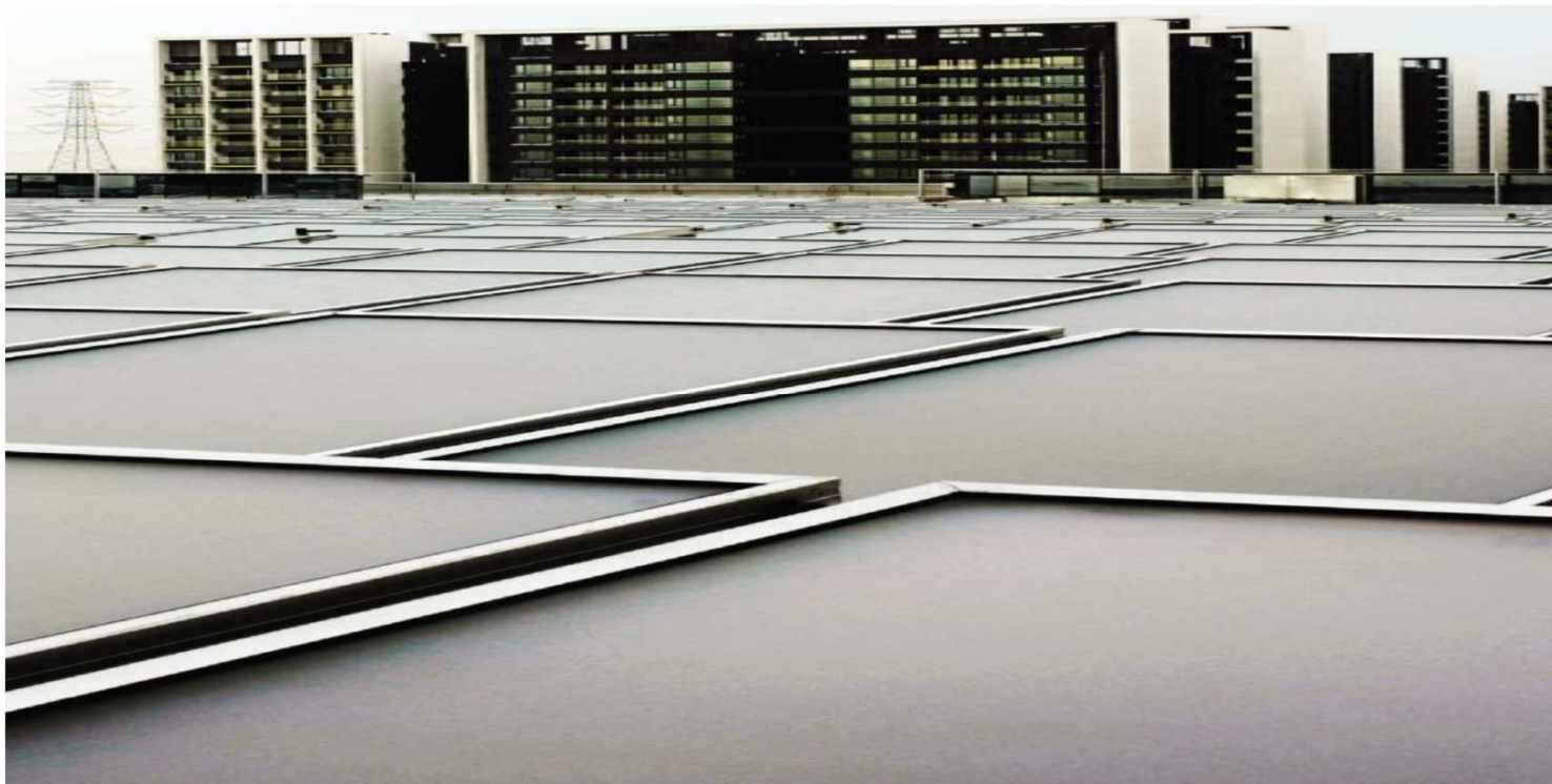
图1 广州亚运会12000m 2 太阳能热水工程
