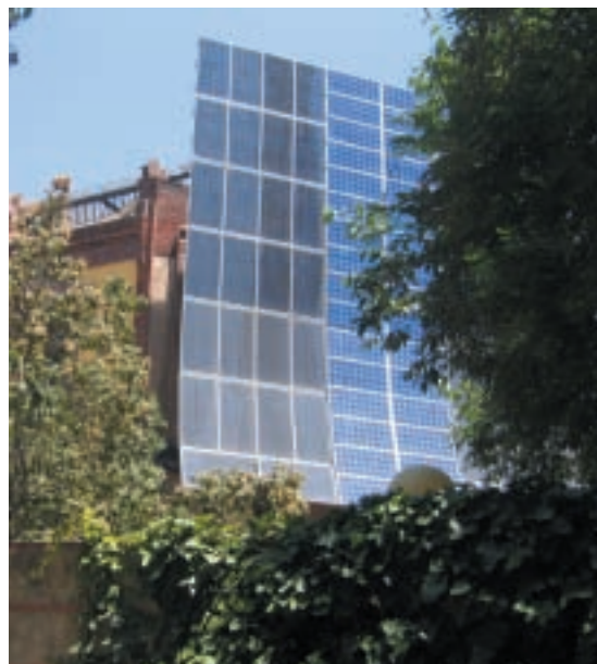
Captadors fotovoltaics en un edifici públic de Barcelona
