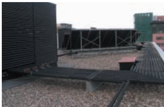
Instal·lació solar per ACS en un terrat
