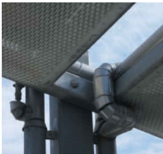
Detall d'una instal·lació solar
