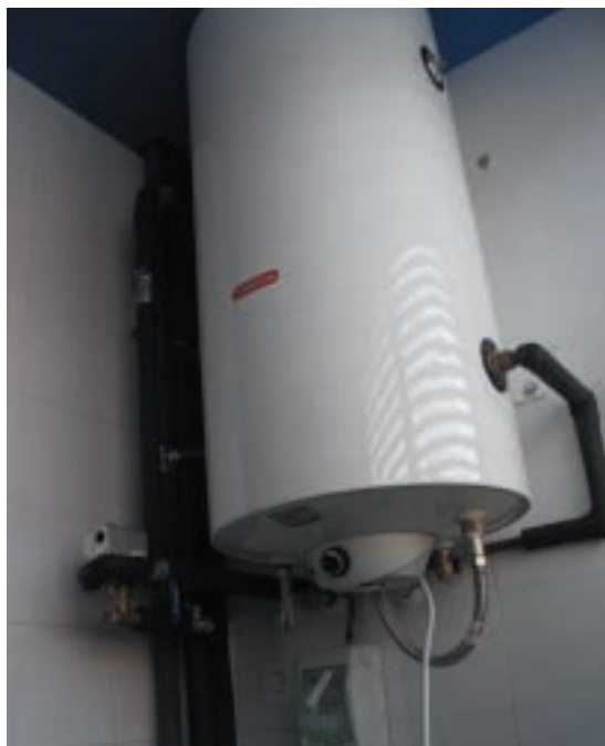
Escalfador elèctric de reforç
